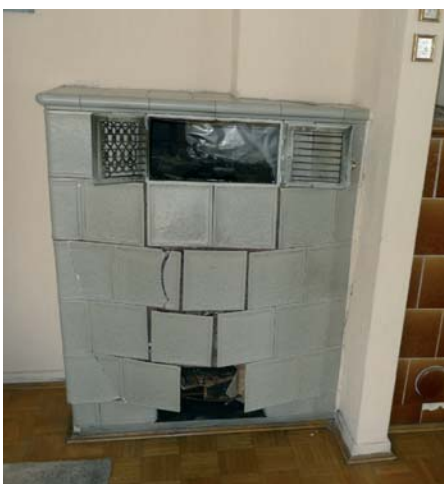
Der Ofen im Wohnzimmer: Die Verkleidung wurde durch die Explosion zerstört.
