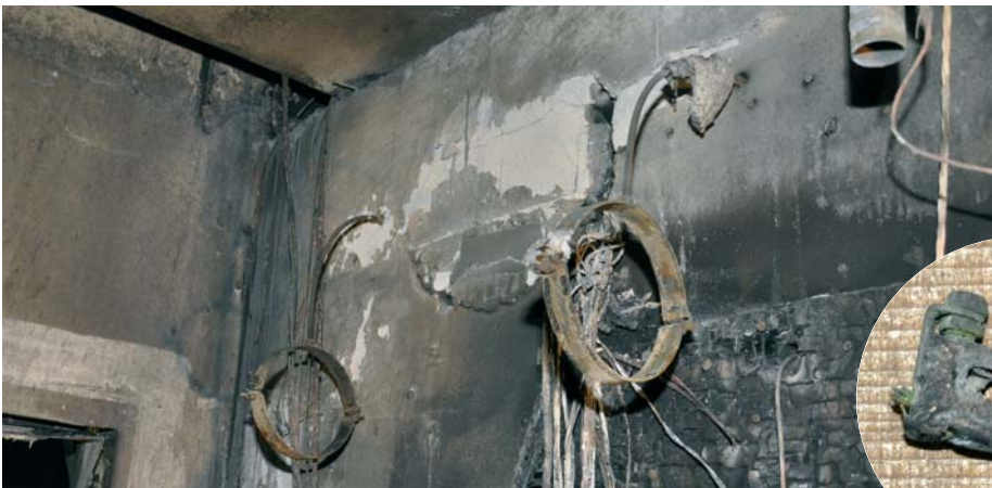
Der Schadensschwerpunkt im Brandraum: An der Klemme im rechten Bild gibt es deutliche Schmelzspuren, die einen Lichtbogenüberschlag belegen.
