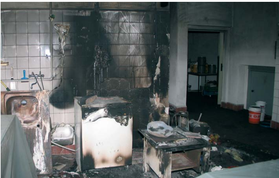
Die Brandstelle in der Küche: Die Spüle wurde bereits demontiert. An der dahinter liegenden Wand gibt es intensive Beaufschlagungen, und die Fliesen sind zum Teil abgeplatzt.
