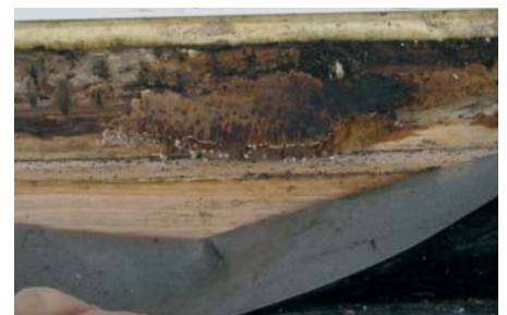
Fruchtkörper am Schwellholz eines Fensters
