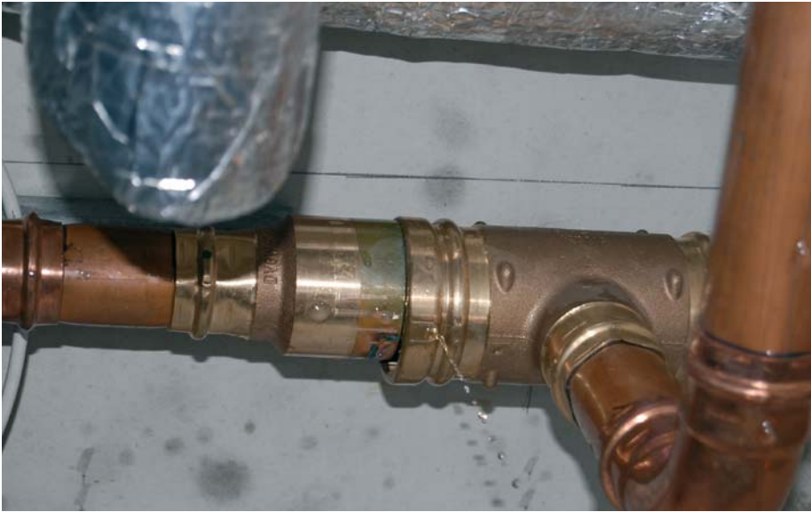
Die Einbausituation: Das Reduzierstück wurde aus der Muffe herausgedrückt.
