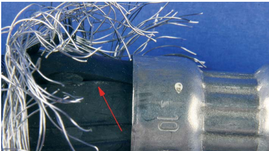
Die Leckagestelle in der Detailansicht: Im schwarzen, gummielastischen Innenschlauch des flexiblen Anschluss-Schlauches klafft ein langer Riss.
