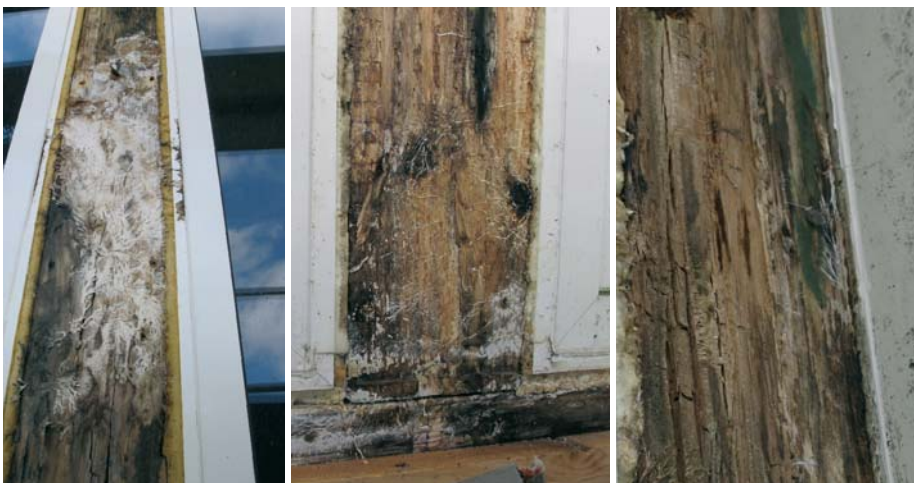
Unterschiedliche Schadenbilder an den Hölzern der Fassade
